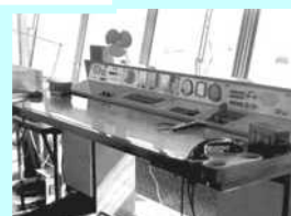
Kontrolní věž pracoviště řídicího létání
